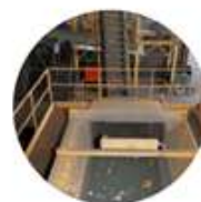
SEPARAZIONI DEI METALLI dagli inerti con MOTORI LINEARI (correnti di Foucault)
